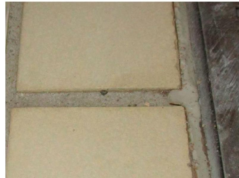
Eroderede fuger i badeværelser.
